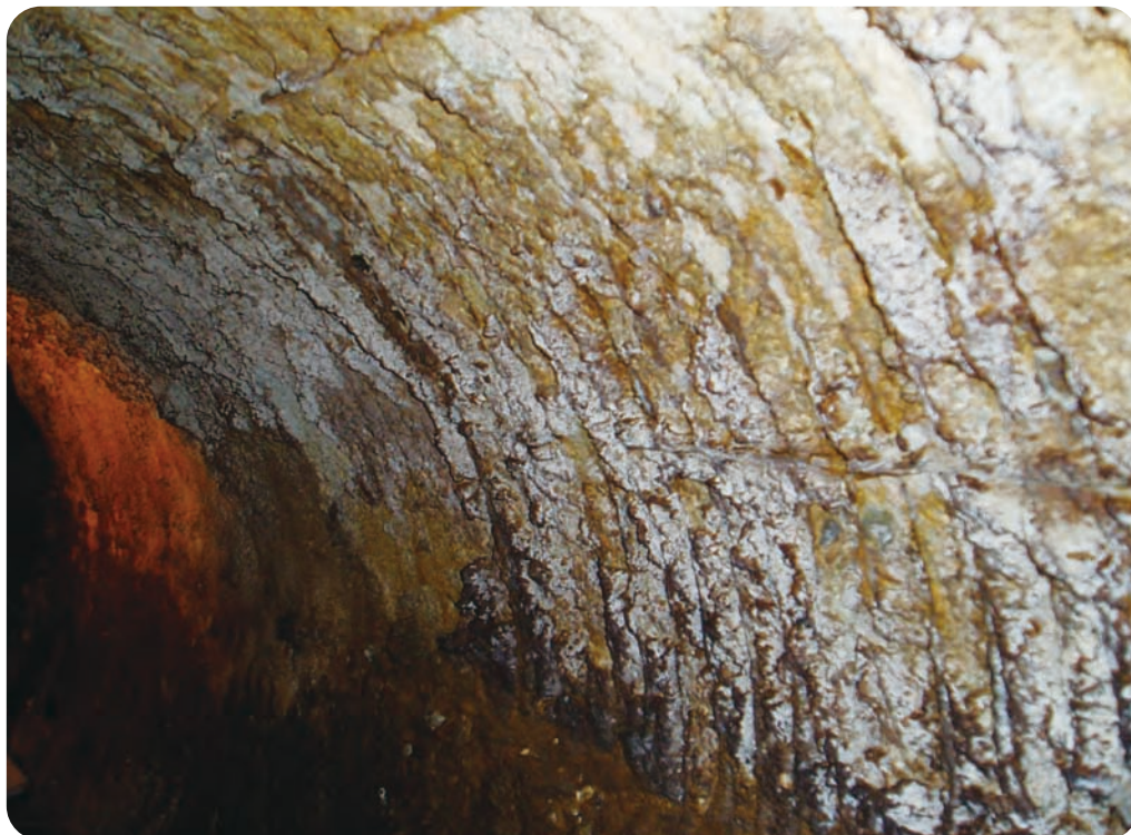
鉄筋が露出している管きよ
